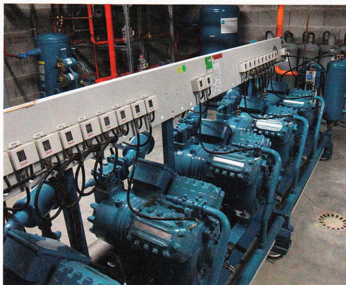
Blick in die Kältezentrale von „Super U“
