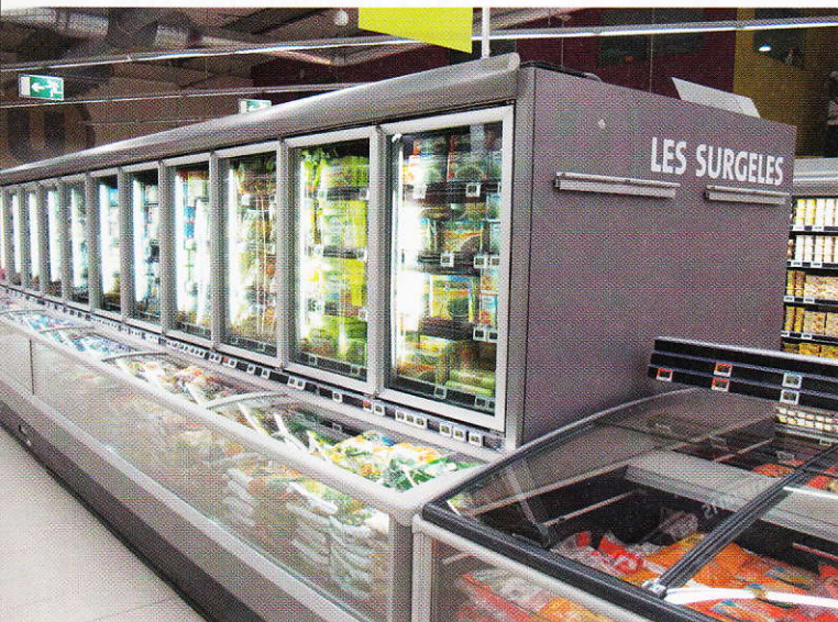
Neben dem neuen Kältemittel „Genetron Performax LT“ ist das Geschäft mit einem Temperaturkontrollsystem „Rsystem“ für alle in den Kühlkammern und Kühlvitrienen gelagerte Lebensmittel ausgestattet.
